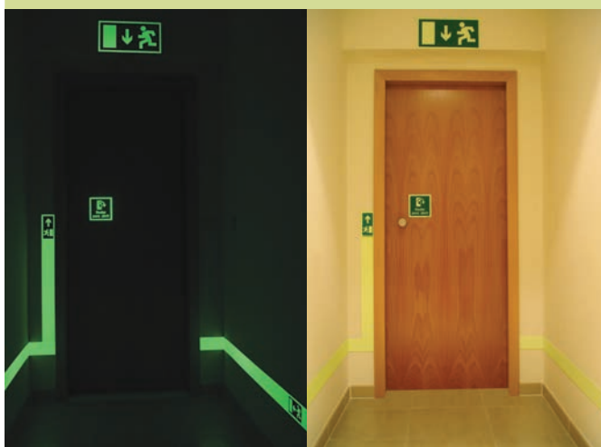
Exemple d'une porte sans éclairage ou avec éclairage
